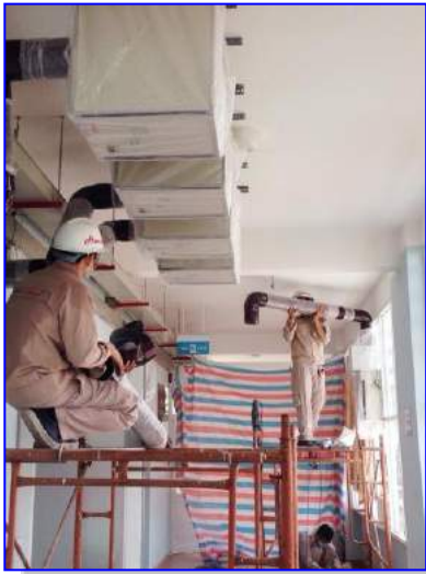
Hệ thống công nghệ UCASS được thi công lắp đặt đơn giản và rất nhanh chóng ngay cả đối với các phòng mổ đang hoạt động
