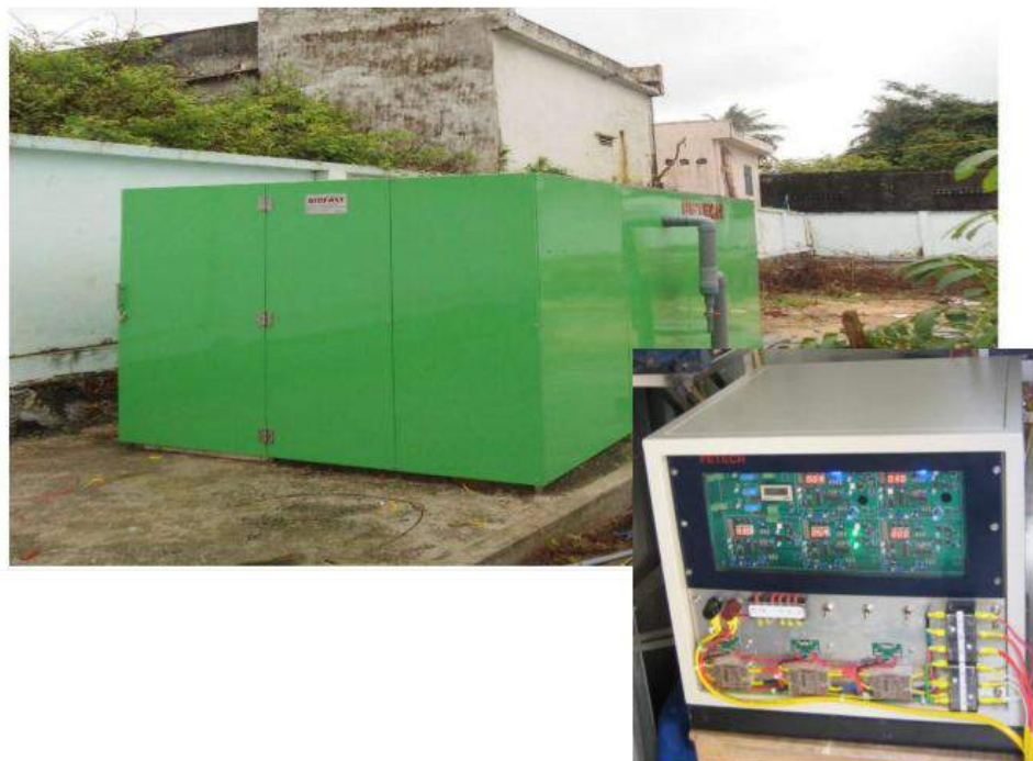
Hệ thống Xử lý nước thải Y tế công suất nhỏ tại Bệnh viện An Thới (Huyện Đảo Phú Quốc, tỉnh Kiên Giang)
