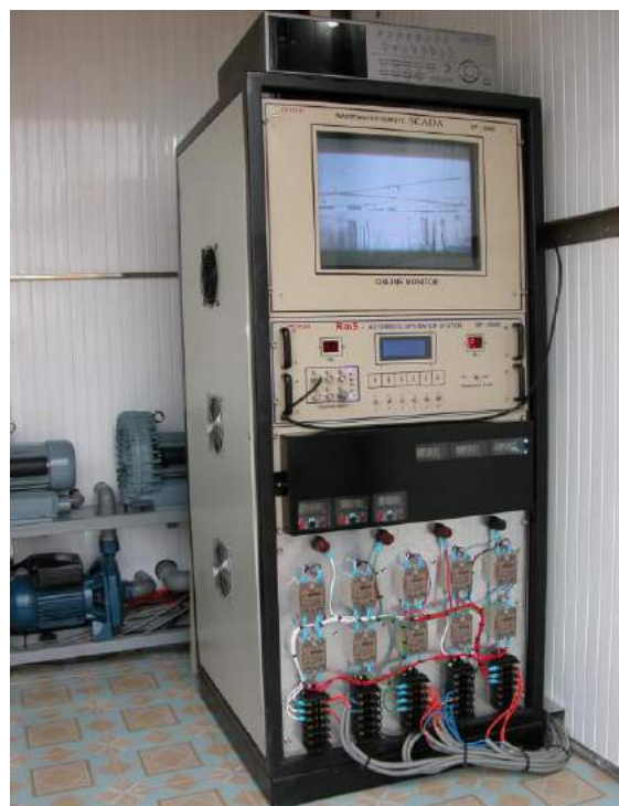
HỆ THỐNG XỬ LÝ NƯỚC THẢI Y TẾ BIOFAST TẠI TRÀ ÔN – VĨNH LONG - 2008
