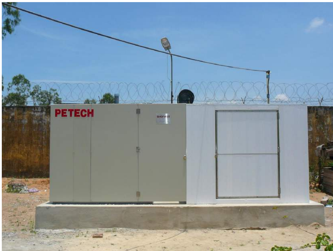
Hệ thống XLNT tại Trại giam của Công An, tại TP. Tam Kỳ - tỉnh Quảng Nam
