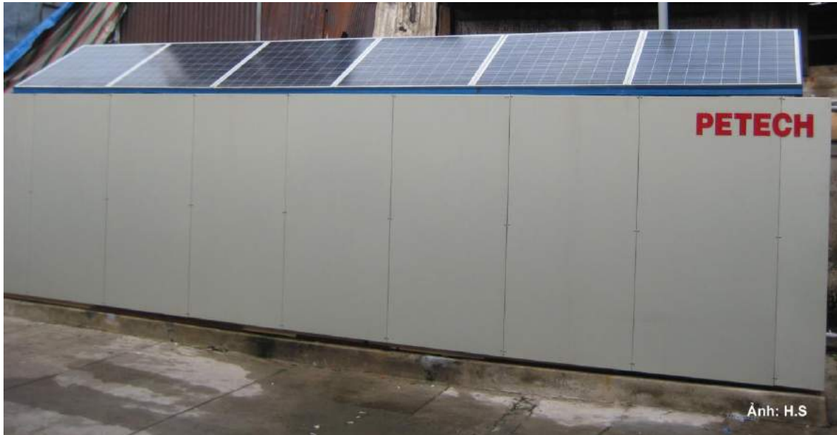
Hệ thống xử lý nước thải bằng NLMT được lắp đặt vận hành tại Bệnh viện Chợ Rẫy
