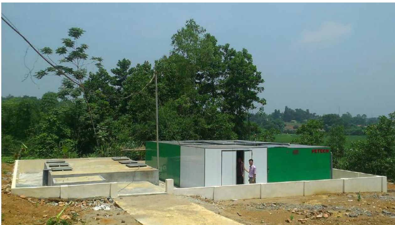
Xử lý nước thải khu điều trị phong Quốc Oai – Hà Nội, công suất: 100m 3 /ngày
