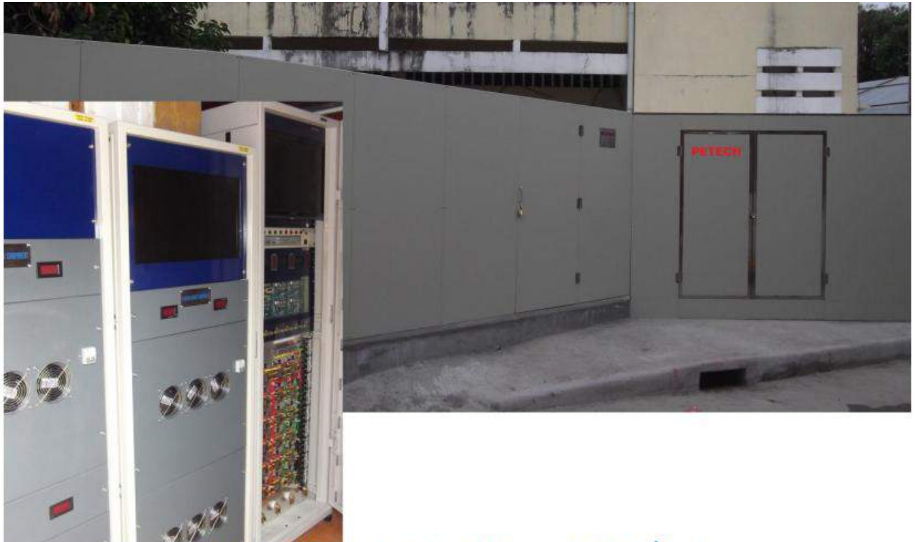
Hệ thống Xử lý nước thải y tế công suất 500 m 3 /ngày tại Bệnh viện Bà Rịa (Tỉnh Bà Rịa – Vũng Tàu)
