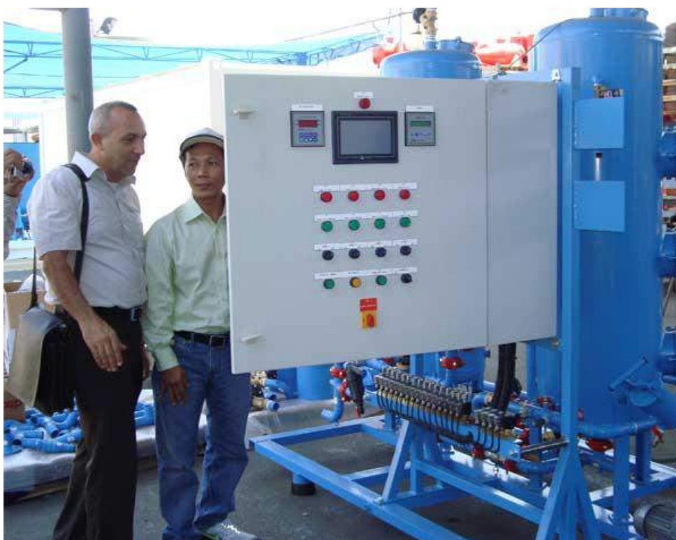
Hệ thống điều khiển RmS tự động cho xử lý nước thải.
