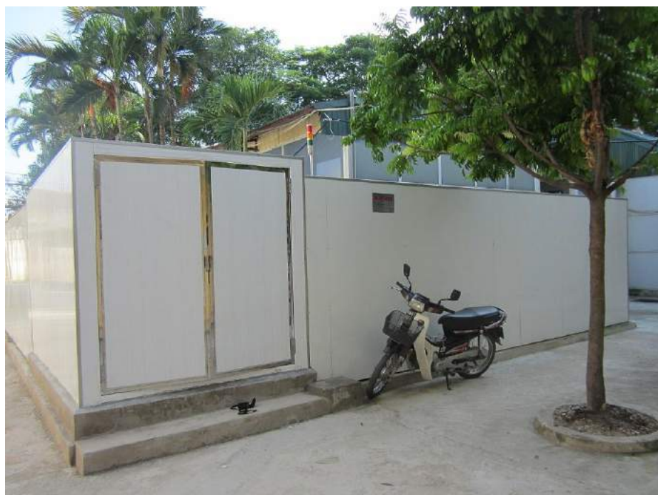
Hệ thống xử lý nước thải bệnh viện 09 – Hà Nội, công suất 100m 3 /ngày
