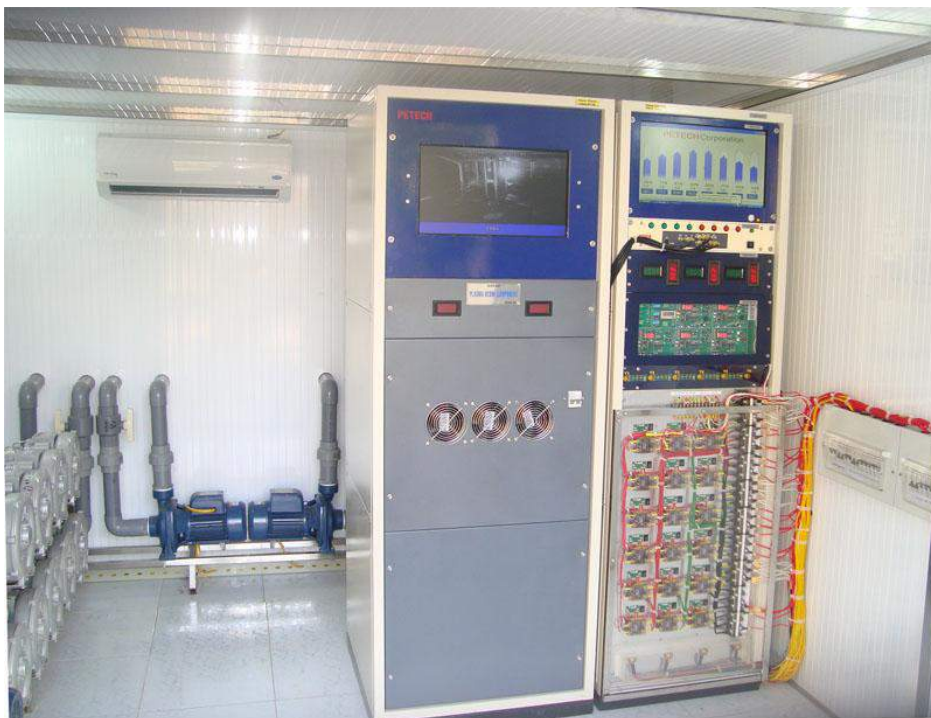
Hệ thống điều khiển RmS XLNT bệnh viện Mộc Xuyên – BR. Vũng Tàu, công suất 120m 3 /ngày.
