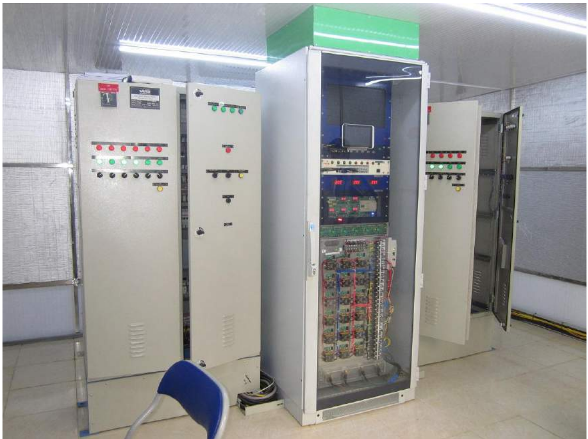
Hệ thống điều khiển xử lý nước thải và thu hồi nước Nhà máy nước Yên Phụ - Hà Nội, công suất: 2.400m 3 /ngày
