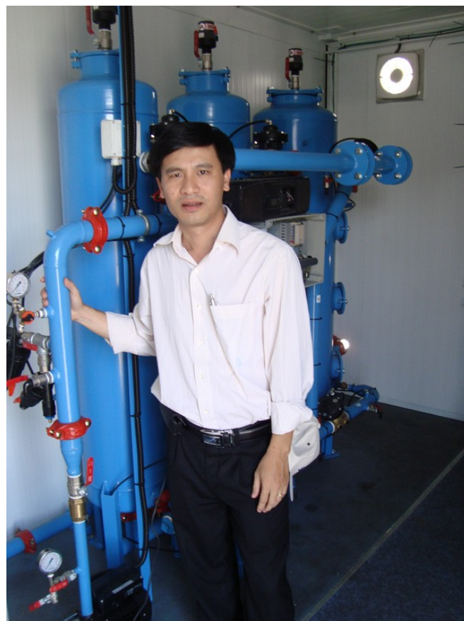
Thiết bị xử lý nước lắp đặt tại xưởng
