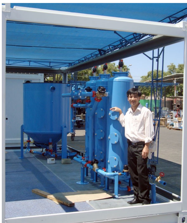
Hệ thống được thiết kế đặt trong container 20ft
