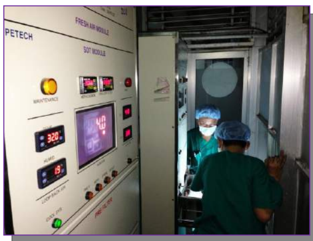
Đội ngũ kỹ sư của Công ty HMED đang lắp đặt Hệ thống UCASS_cấp khí siêu sạch áp lực dương cho phòng mổ ghép gan
